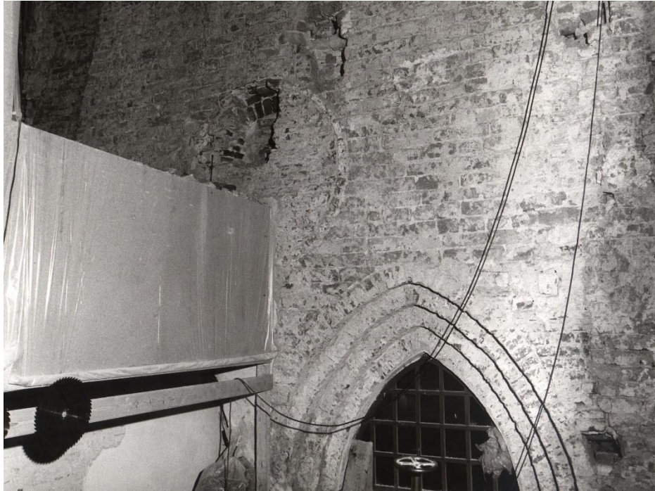
85. De ontleisterde zuidmuur ter hoogte van de vroegere kapel.
