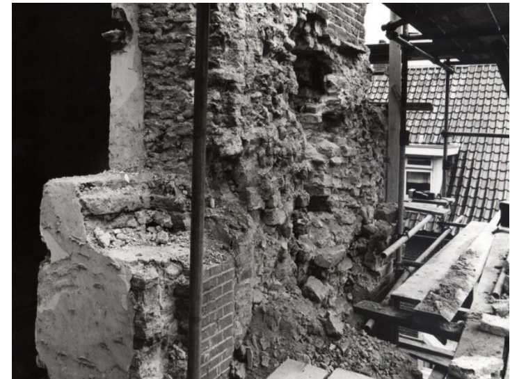
72 - 73. Deze foto's, gemaakt op de steiger, maken duidelijk dat het (nodeloos) 'afpellen' van het kistwerk aan de noordoostzijde niet zonder schade heeft plaatsgevonden.
